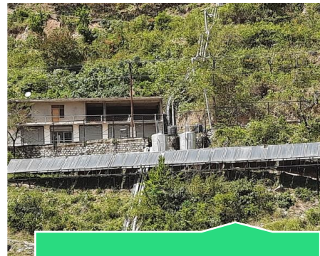
Solar PV 200 KW
