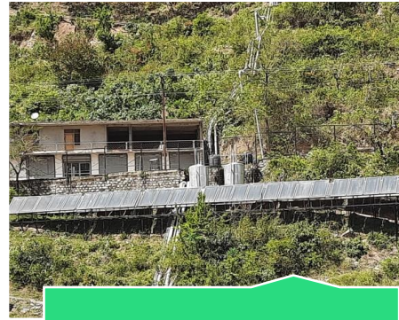
Solar PV 200 KW
