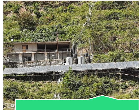
Solar PV 200 KW
